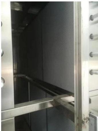
废气处理措施活性炭吸附装置
