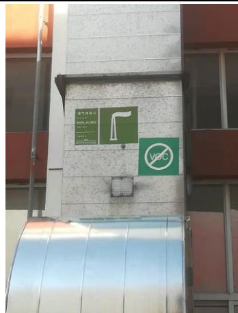
废气排气筒标识标牌
