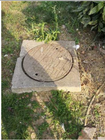
生活污水排口
