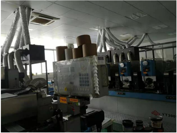
印刷车间废气收集管道
