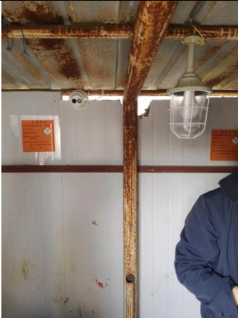
危废仓库防爆灯
