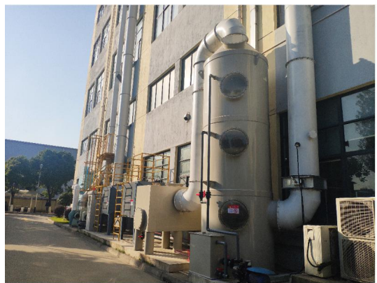
废气处理设施
